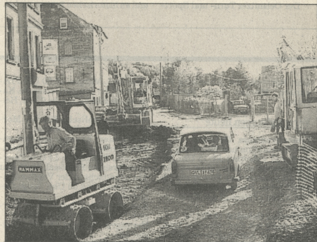
Im vollen Gange ist gegenwärtig die mehrfach verschobene Instandsetzung der Karlsgasse in Adorf. Foto: Sulski
